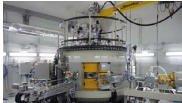
O Cyclone® 30 da IBA com 3 linhas de transporte de feixes instalado no KFSHRC em Riade, Reino da Arábia Saudita.
